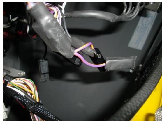
Abb. 4 - Isolierung des Kabelendes
