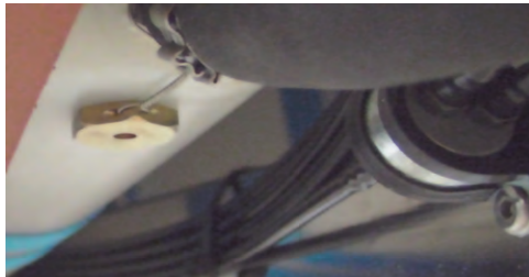
Drainventil am Tankboden
